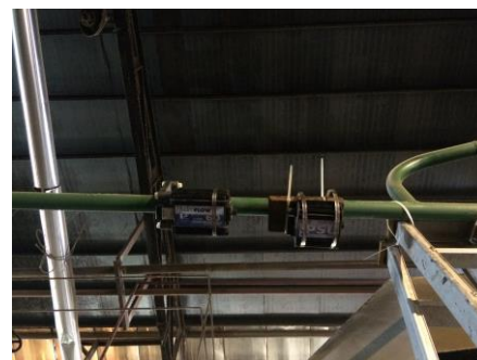
電磁波水垢現場設備安裝位置
