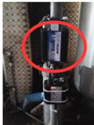
電磁波水垢現場設備安裝位置
